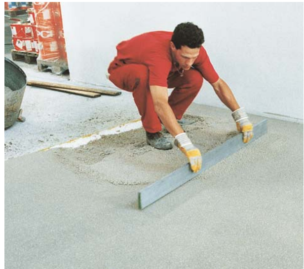
Wykonywanie wysoce odpornego na ścieranie i chemoodpornego jastrychu przemysłowego na bazie zaprawy PCI Bauharz
