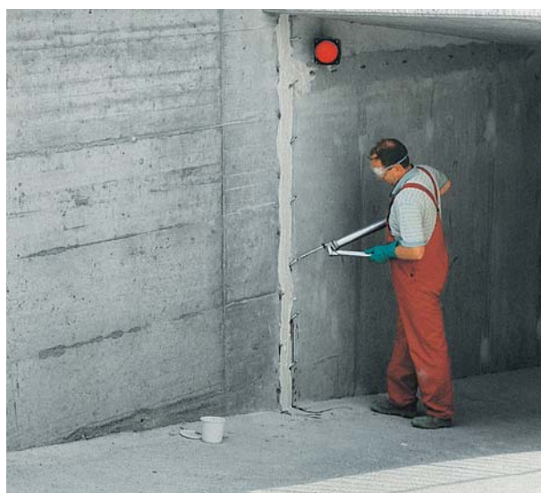
Po uszczelnieniu powierzchni rysy np. klejem PCI Collastic i osadzeniu iniektorów wierconych lub naklejanych wykonuje się przy użyciu PCI Apogel A zamykające siłowo połączenie zarysowanych elementów.
